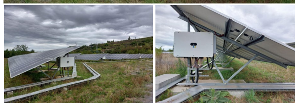
Câblage hors sol adapté au site
