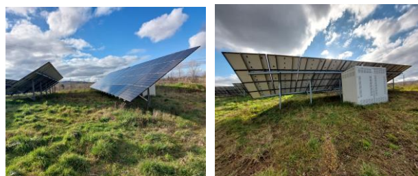
Equipements du site
